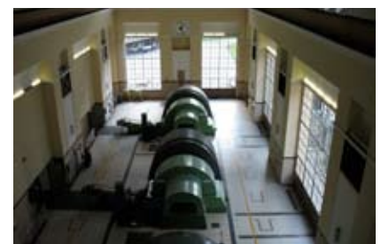
Vista dell'interno della centrale di Caoria
